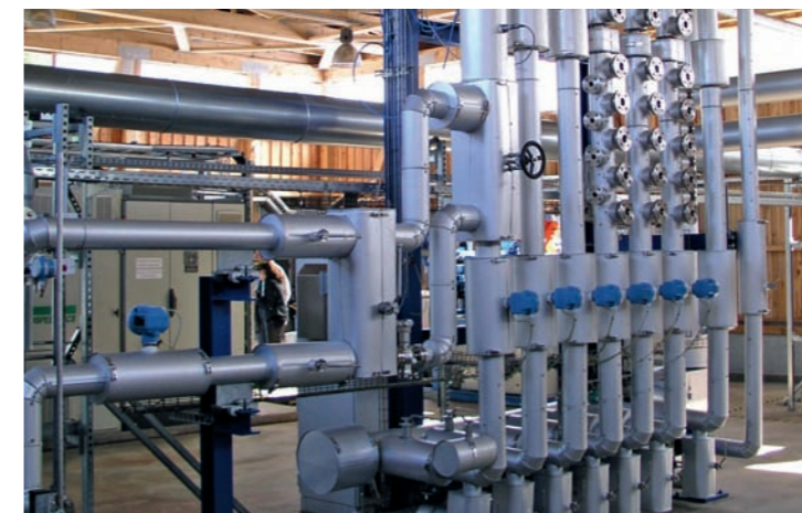
In den Thermalwasserkreislauf integrierter Korrosionsbypass (Foto: M. Renner, Bayer Technology Services)
